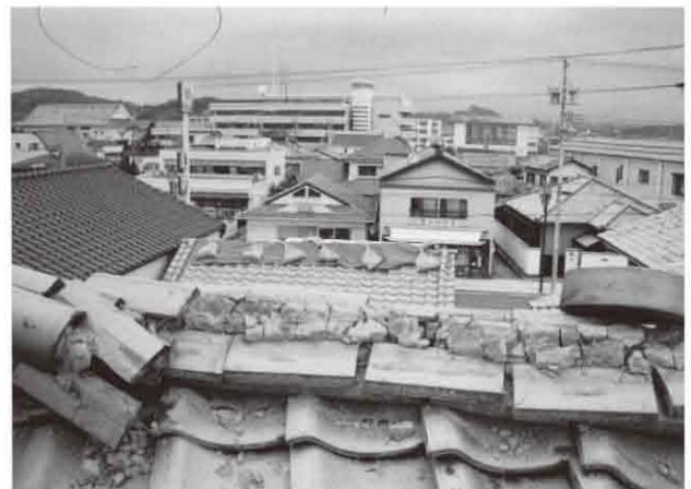
5. 下の棧瓦の固定が悪く、棧瓦の振れにより棟が壊れた
