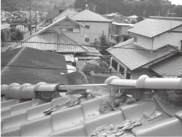
7寸丸1本伏せ仕様 損壊写真
