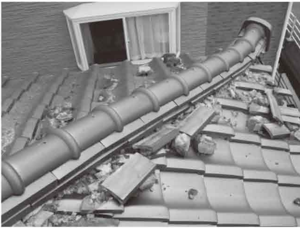
1. 熨斗瓦の銅線緊結がしてない
