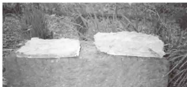
写真5 崩落したなまこ壁の厚さ
