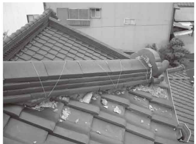
6. 棟全体を銅線の大回しでしか施工していない
